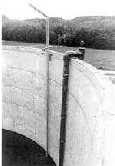
Bild 4: Stahlbetonhochbehälter zur Lagerung der Gülle
