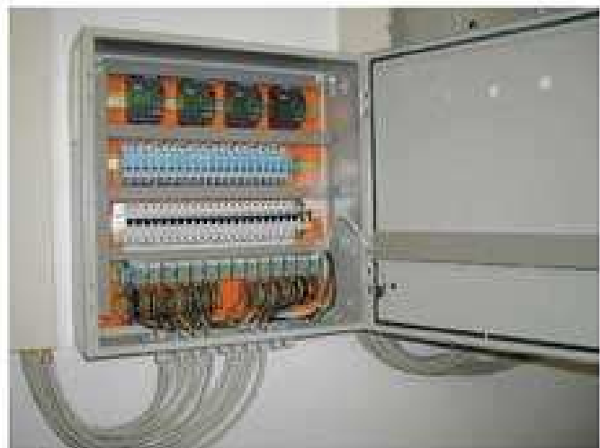
Abb.8: Schaltkasten zur vollautomatischen Steuerung der Klimatisierung und des Lichtprogramms. (Feldner/Möller)
