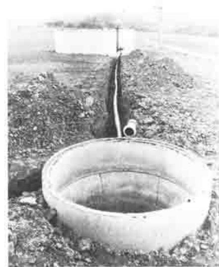
VORGRUBE aus Betonringen mit 200 cm Durchmesser und Druckleitung aus PE-Rohr, DN 150 zum Hauptbehälter.
