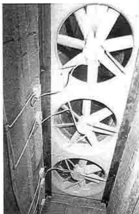
9 Blick in den Fortluftkamin aus dem zentralen Abluftsammlkanal. Ventilator 1 in Betrieb, andere Ventilatoren in Ruhestellung
