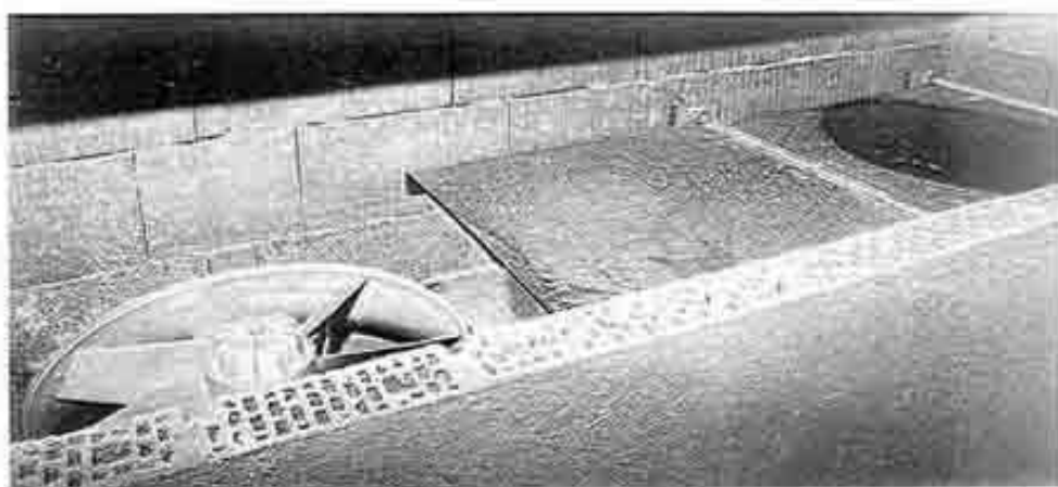
10 Blick in die Revisionsöffnung des Fortluftkamins. Ventilatoren 2 und 3 außer Betrieb und mit Stellklappe abgedeckt
